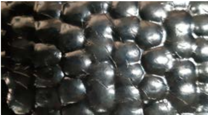
Oberseite der Gummideckbahn mit Abdrücken der Risse
